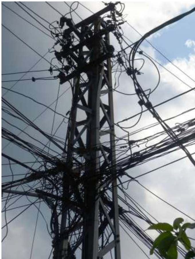
foto sopra: situazione ingarbugliata
